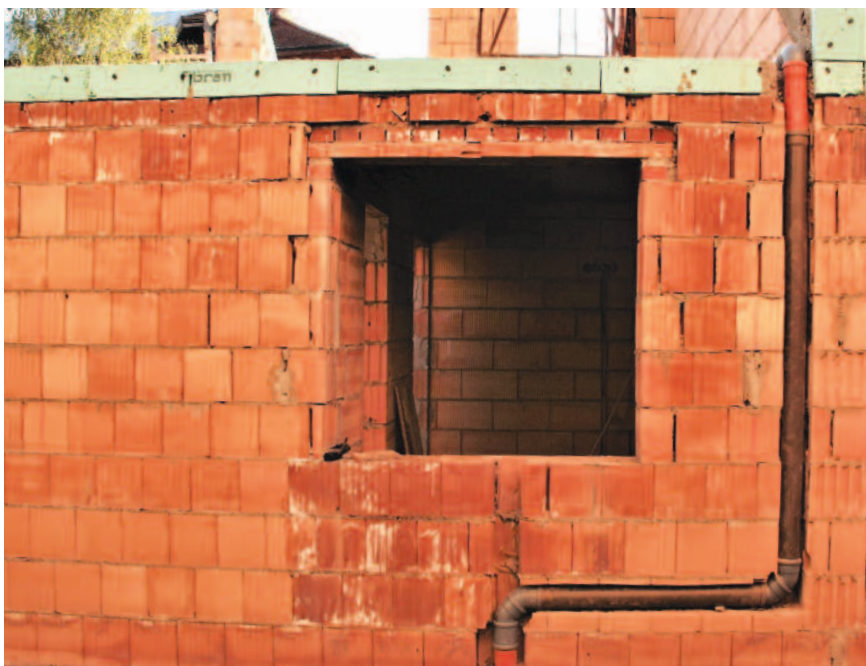
1. kép – Ez az eredmény, amikor az építető szereli a szennyvíz-csatornát, mert meg akarja spórolni a gépész terv árát.
